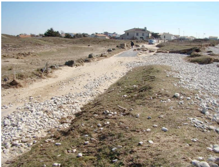
Fig. 14 – Vue vers le sud de la route côtière détruite par la tempête : on voit l'état fragmenté du cordon dunaire, qui a favorisé la pénétration des vagues et renforcé l'efficacité de leur action érosive.
