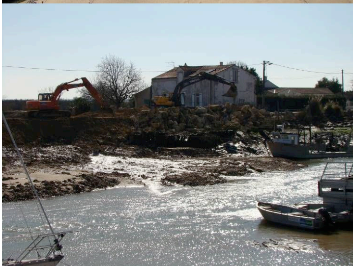
Fig. 11 – Travaux de réfection des berges dans la partie aval du chenal de la Perrotine une semaine après le passage de la tempête.
