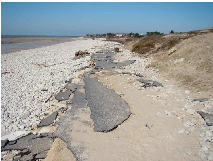
Fig. 15 – Vue vers le nord de la route côtière qui a été détruite par les vagues : le maigre cordon dunaire qui séparait la plage de galets de la route a été emporté par les vagues, ce qui a favorisé la migration du cordon de galets vers l'intérieur. Il occupe aujourd'hui l'emplacement de la route.
