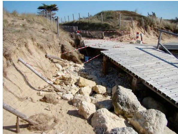
Fig. 28 – Rampe d'accès de la plage de la Rémigeasse : l'érosion de la dune de part et d'autre de cet équipement a provoqué sa déstabilisation.
